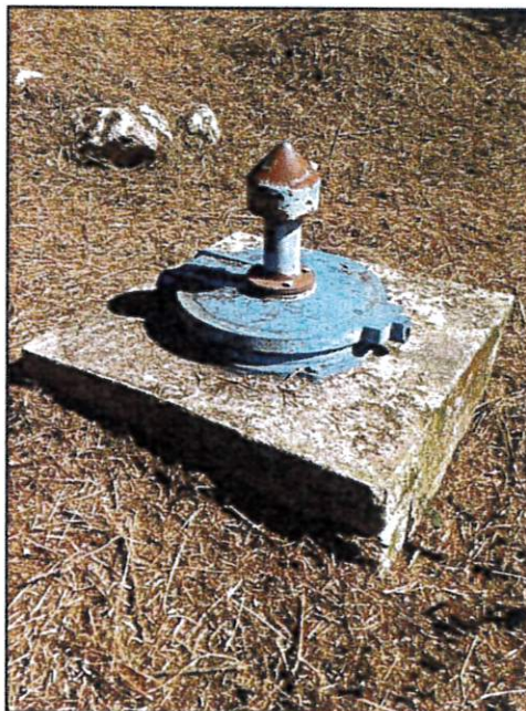
Captage Pitraghju 1, cuveau de collecte
